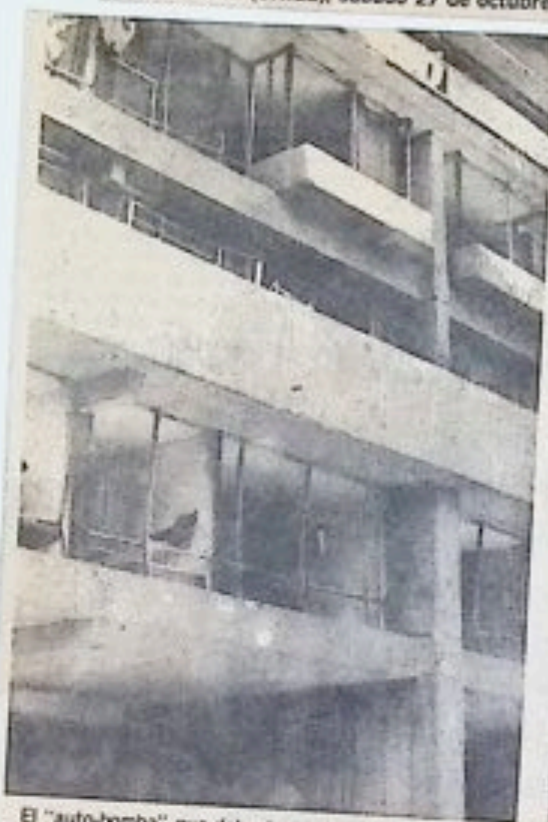
El "auto-bomba" que detonó ayer junto al edificio Diego Portales produjo también quebrazón general de vidrios, y aun de marcos de ventanas (como se aprecia en la foto de la
